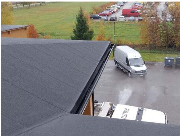
83. Rästaskourut varustettu sulanapitokaapeilla.
