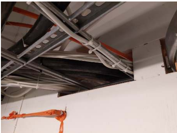
1. Sähköpääkeskuksen tiivistämättömiä läpivientejä.
