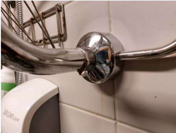
118. Käyttövesipatterin tiiviste vuotaa.
