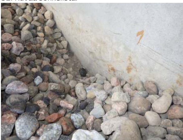
34. Sokkelin ulkopuolella ei vedeneristettä.
