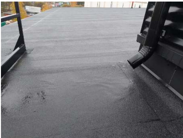
77. Vedenohjausta IV-konehuoneen katolta
