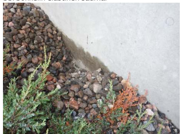
35. Sokkelin ulkopuolella ei vedeneristettä.
